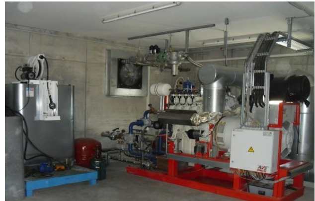
Abbildung 1: BHKW mit einer installierten elektrischen Leistung von 250 kW
