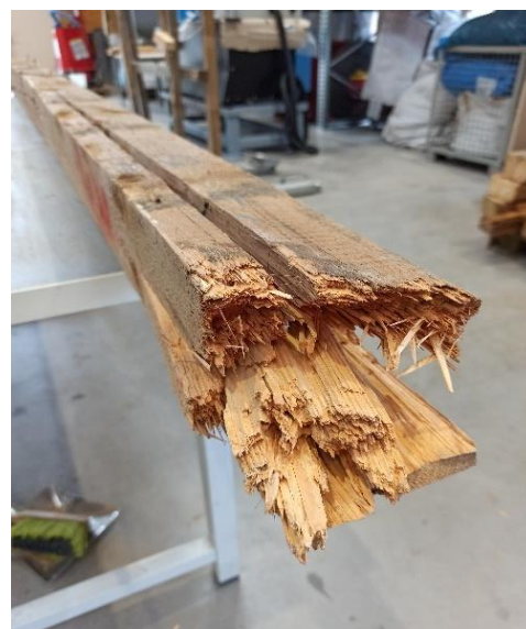
Beschädigter Dachbalken (Ausrisse) durch Rückbau
