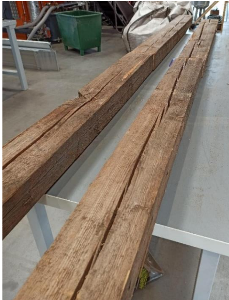
Dachbalken mit wenigen Bfm
