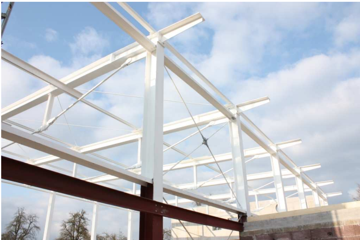
Sonnige Aussichten! Auf dieser Dachkonstruktion in Seeborn sollen bald Solarkollektoren aus Sonne Strom machen.
