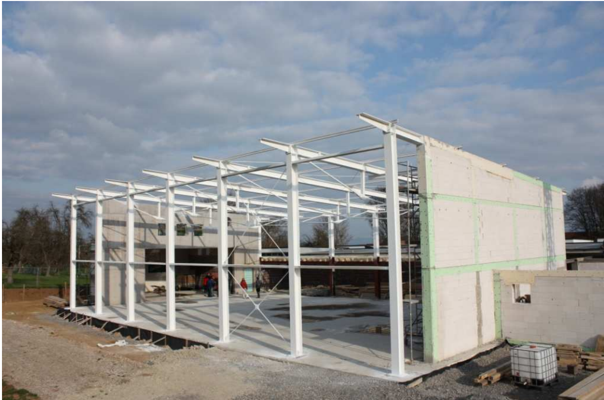
Der Rohbau der Sport- und Gemeindehalle in Seeborn steht. Die Arbeiten laufen mit Hochdruck und vielen fleißigen Helfern.
